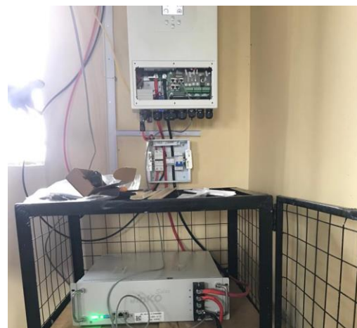
Ausschnitt aus der „Schaltzentrale“
